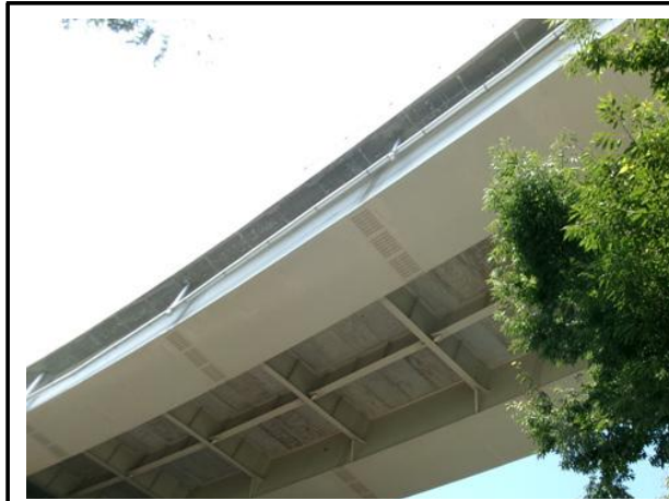
바닥관하면 S1 캔틸레버 상태현황
