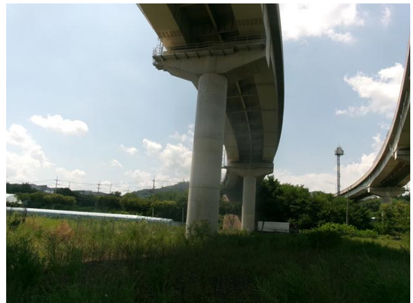
교각 P2 상태현황
